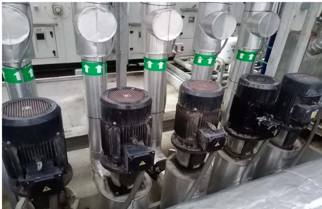
ภาพที่ 8 ปั๊มน้ำขนาด 15 kW
